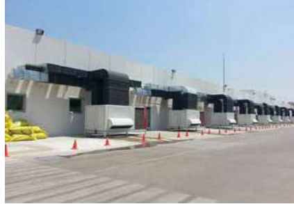
Eldor Elektrik Fabrikası - İzmir
